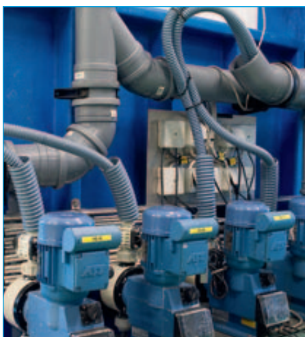
Det krävs rejäl utrustning för att hantera flödet av avloppsvatten på Arlanda flygplats.
